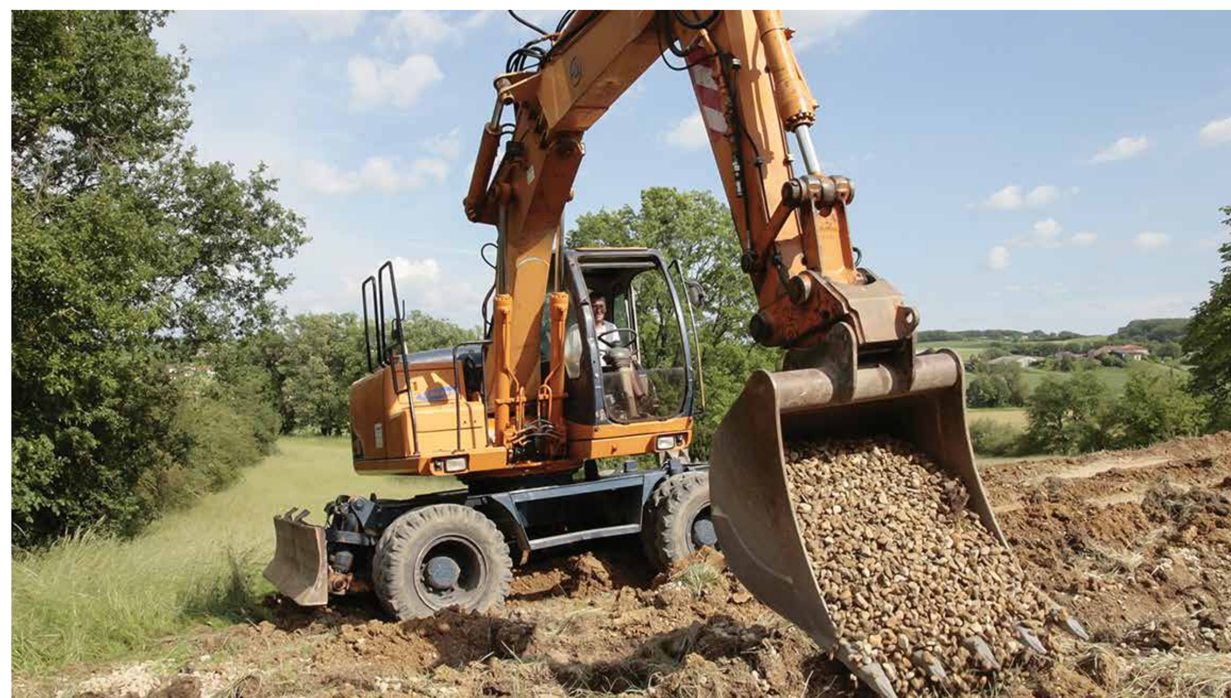
Travaux de terrassement illégaux sur une zone humide.
